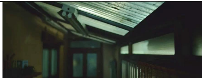
Lampu tidak berfungsi karena mati dan atap yang kumuh.
