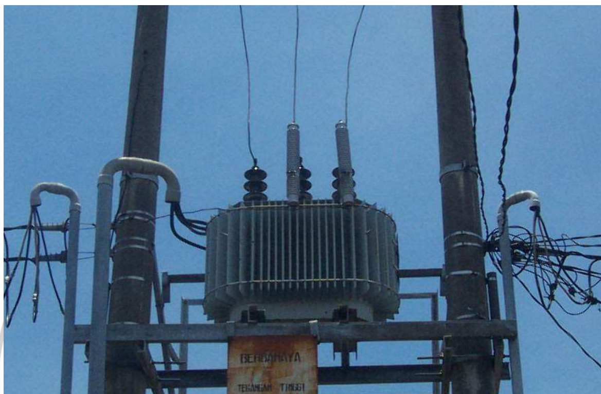
Gambar 2. Trafo Distribusi 200 kVA
