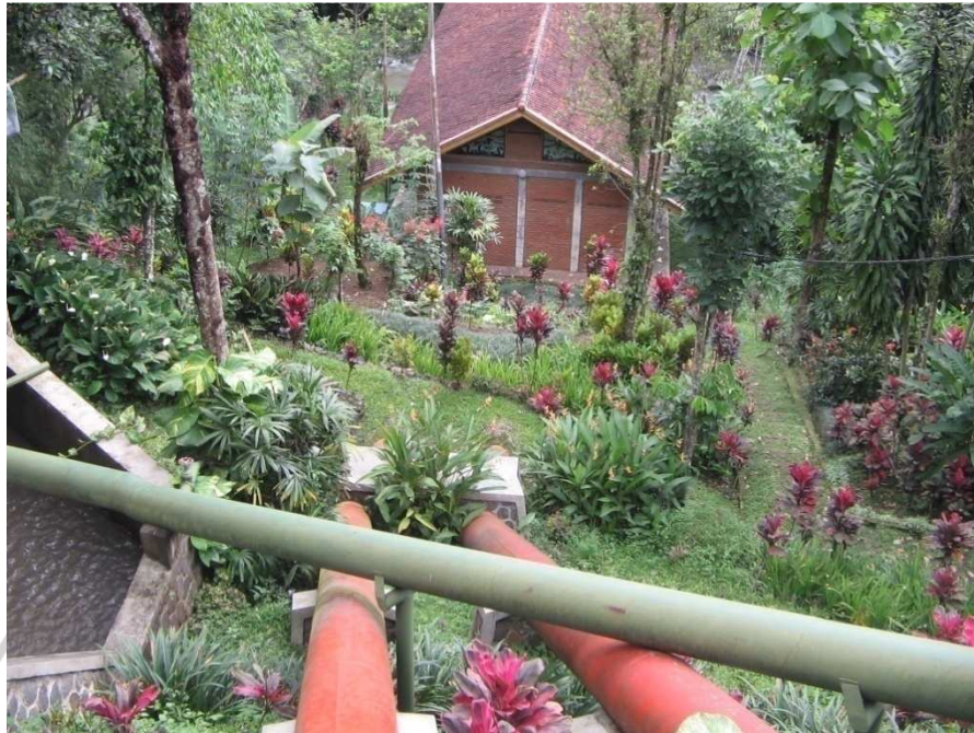
Gambar 3.4 Pipa pesat dan rumah pembangkit
