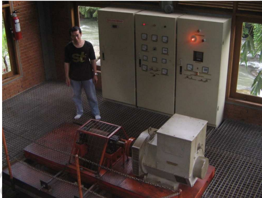
Gambar 3.7 Panel kontrol dan generator PLTMH Cinta Mekar
