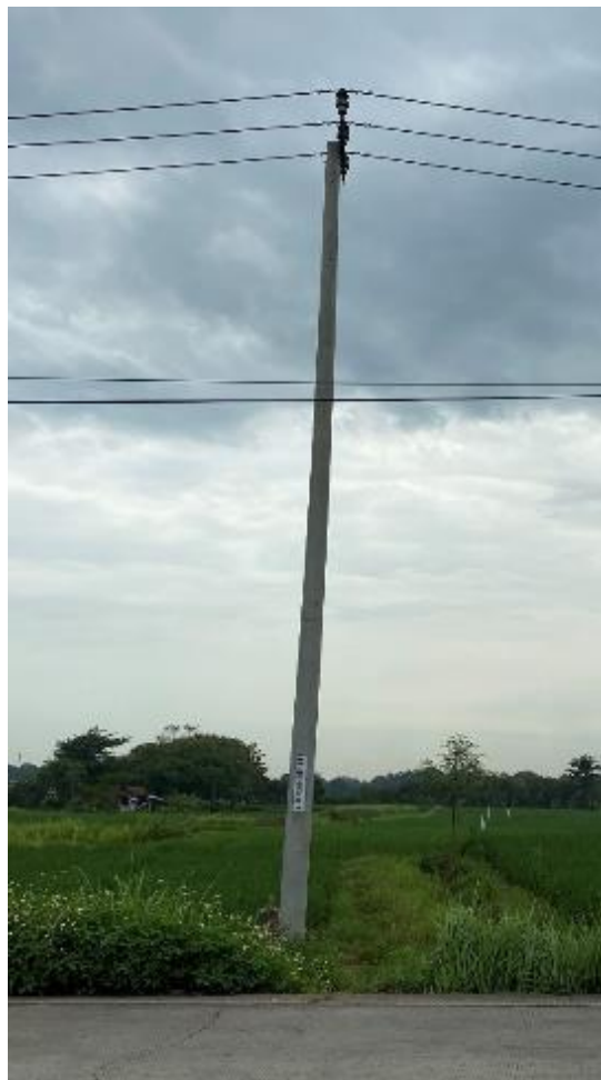
Gambar 24. Tiang Listrik pada Tapak. Sumber Gambar : Dokumentasi Penulis
