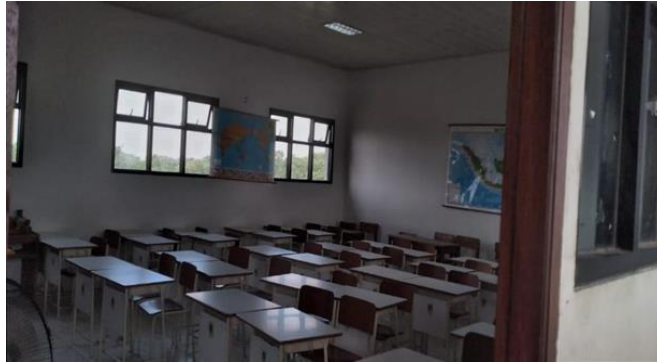
Gambar 4.8. Keadaan Awal Dinding Kelas
