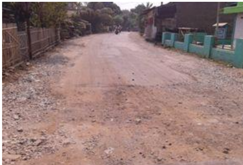
Gambar 3.2 Kondisi Eksisting Ruas Jalan Parigi-Sukamanah
