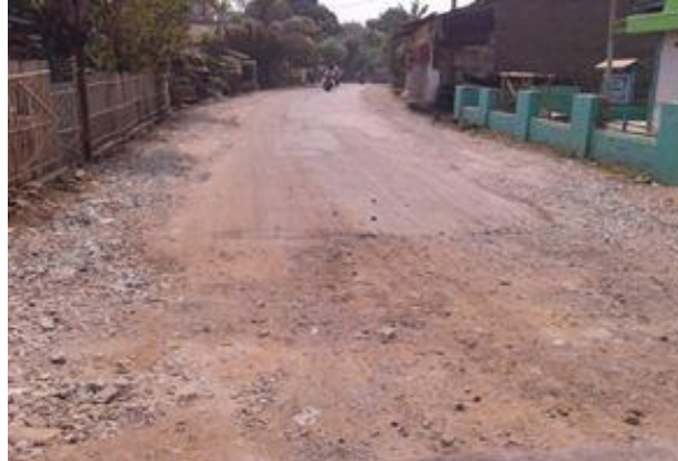
Gambar 3.4 Kondisi Existing pada Ruas Jalan Parigi-Sukamanah
