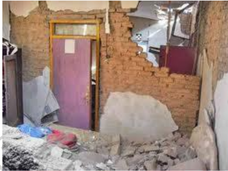
Gambar 1.1 Kerusakan yang Terjadi Pada Dinding Akibat Gempa
