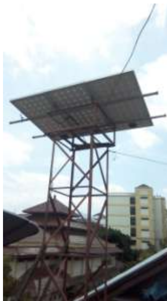
Gambar 3.4 Panel surya pada gedung laboratorium teknologi FPTK UPI
