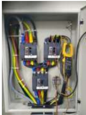
Gambar 3. 5 Proses pengukuran harmonisa pada MDP
