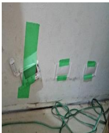
Gambar 3. 7 Mold Sensor (Sumber: Dokumentasi Penelitian)
