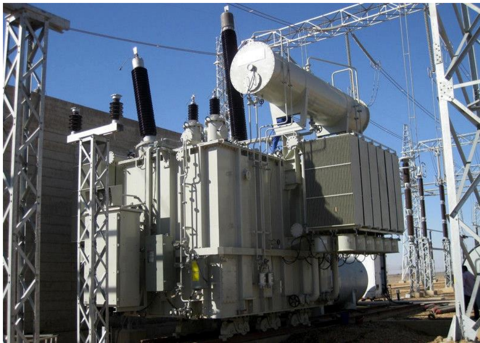
Gambar 3.1 Transformator Daya pada GI Bandung Utara
