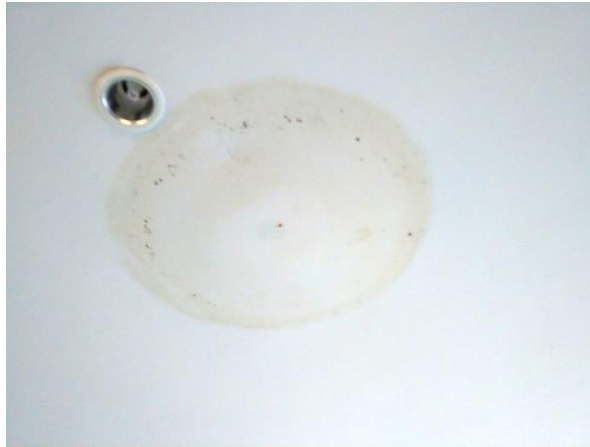
Gambar 3.7 Kerusakan Plafond pada lantai 4(R.Pamer Tidak Tetap)
