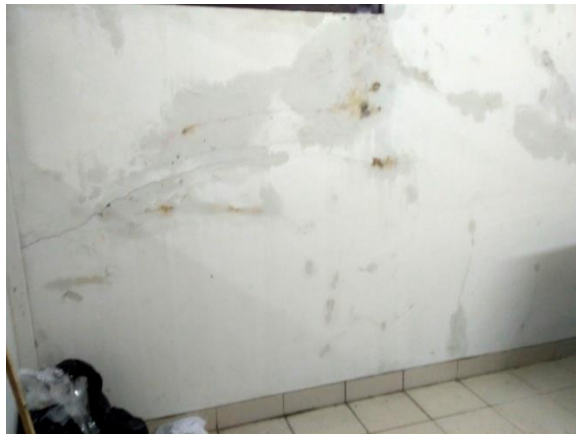
Gambar 3.6 Kerusakan Pengecatan Dinding
