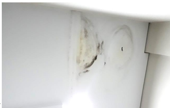
Gambar 3.9 Kerusakan Plafond pada lantai Basement (RuangKurator)
