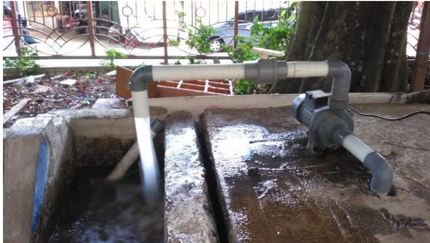
Gambar 3.6 Ketersediaan Pompa (Sumber : Dokumentasi Pribadi)
