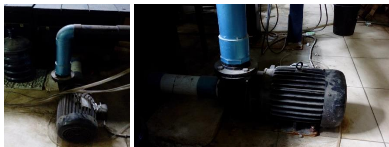
Gambar 3.5 Pompa Air (Dokumentasi Pribadi)
