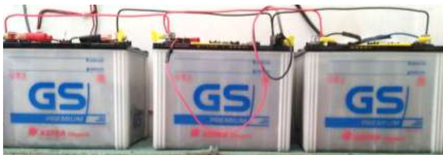
Gambar 3.5 Baterai pada PLTH
