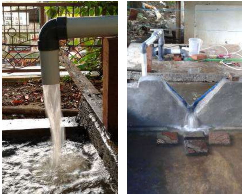
Gambar 3.10 Supply air dari pompa dan kran air (Sumber : Dokumen Penelitian)
