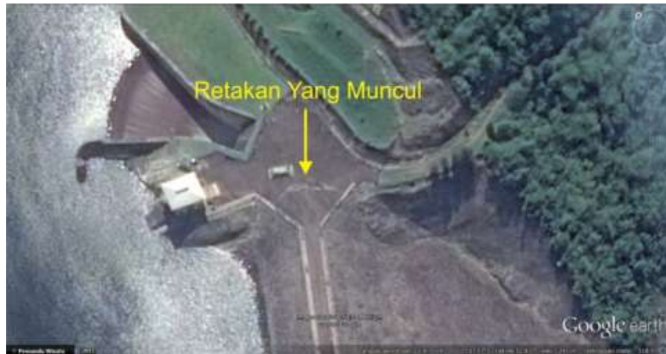
Gambar 3.4. Retakan yang muncul dipermukaan bendungan
