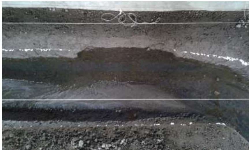
Gambar 1.49 Dinding yang mengalami keruntuhan
