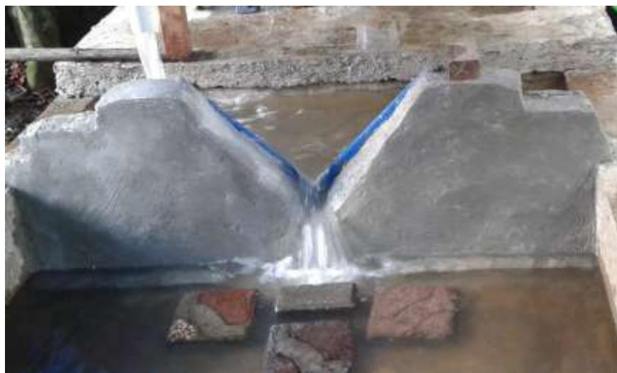
Gambar 1.10 Pintu air ambang tajam V-Notch
