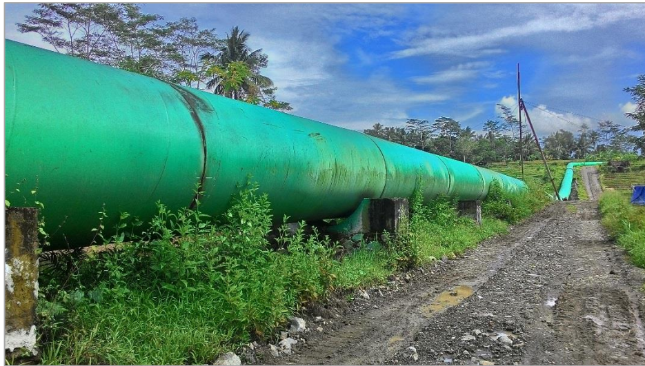
Gambar 1.2. Pipa Air PLTMH Cirompang Tengah Sumber : Hasil Dokumentasi Lapangan
