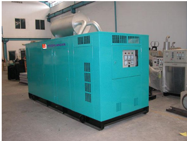
Gambar 5.4. Genset di Rumah Sakit
