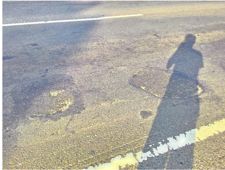
Gambar 1.1. Kondisi Perkerasan Jalan Tol Eksisting
