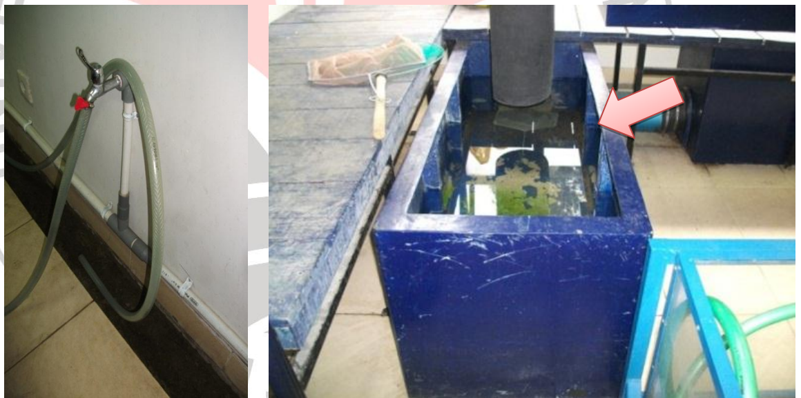
Gambar 3.11 Kran dan sump tank Sumber : dokumentasi penulis
