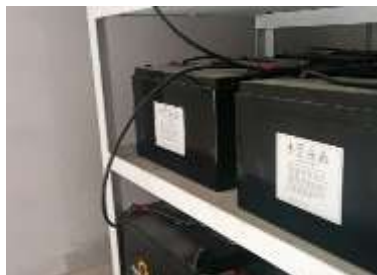
Gambar 3. 5 Baterai lead acid (Dokumentasi pribadi)
