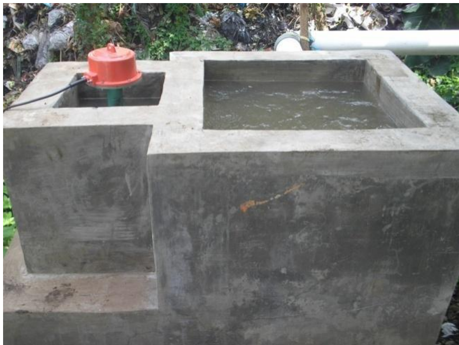
Gambar 3.8 Kolam Turbin dan Kolam Penenang
