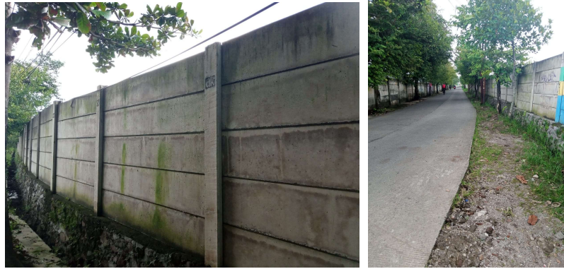
Gambar 3. 2 Pagar Panel Beton di Sekitar Tapak
