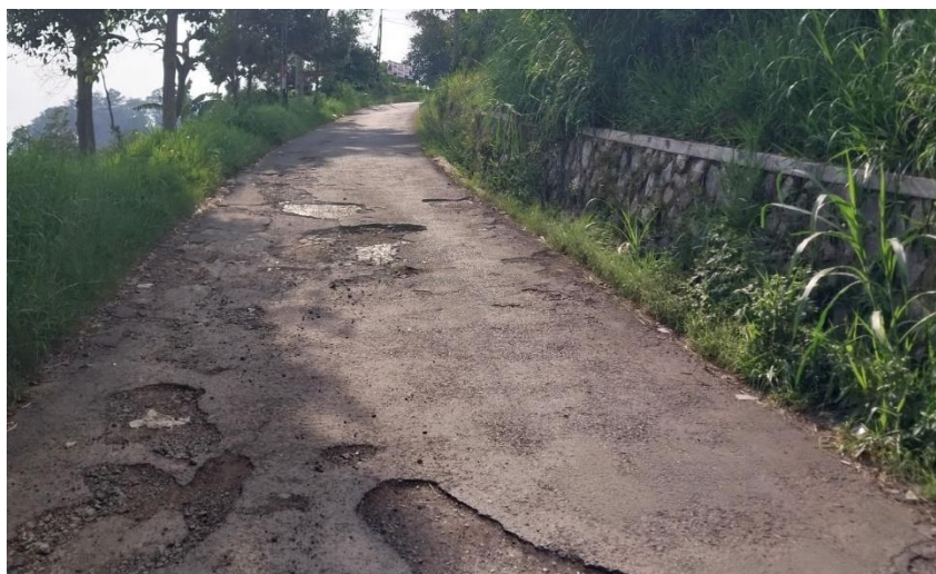
Gambar 1.4 Kondisi Jalan Rusak
